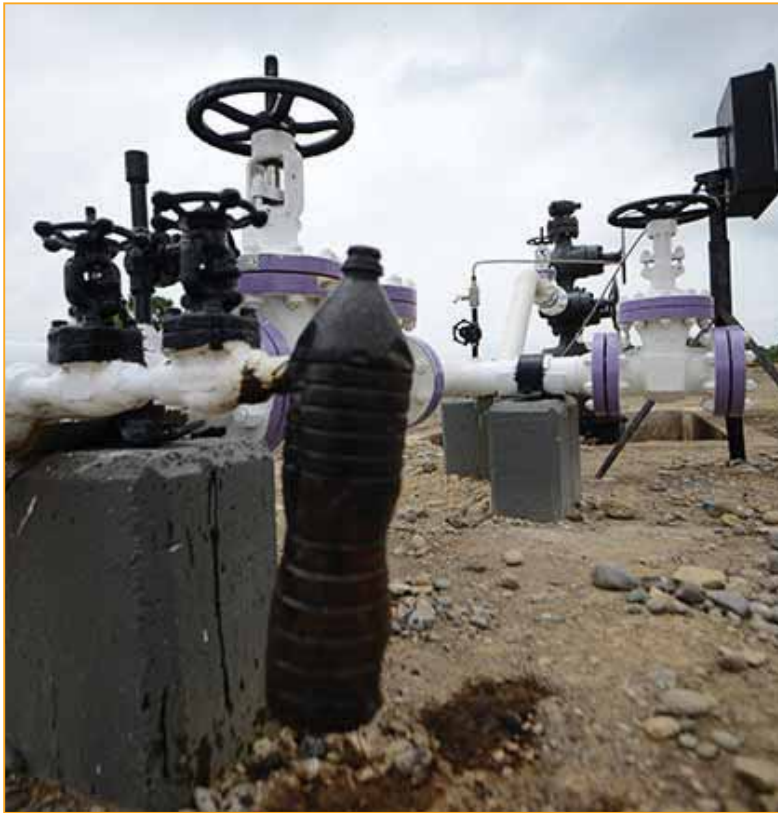
Instalaciones en el norte de Veracruz, México
